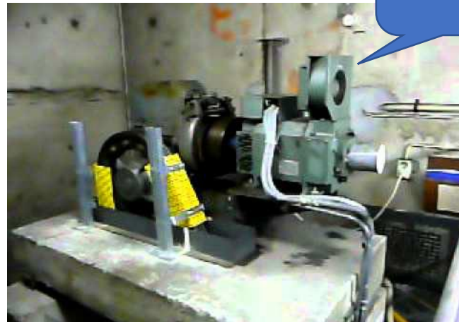
Motor cooling fan
